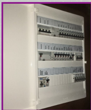
Le nouveau tableau électrique
